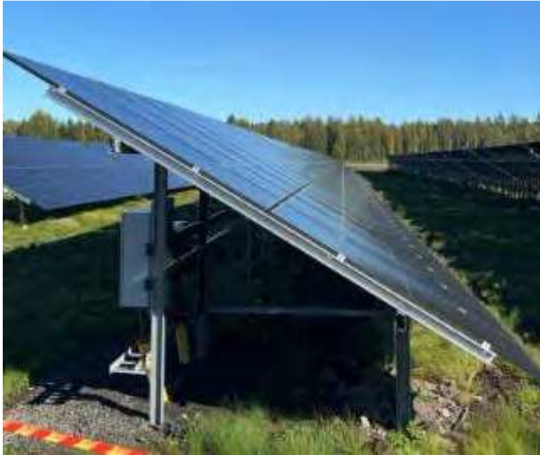
Kuva 8. Omien perustusten varaan asennettuja aurinkopaneeleita (Sitema Oy)
